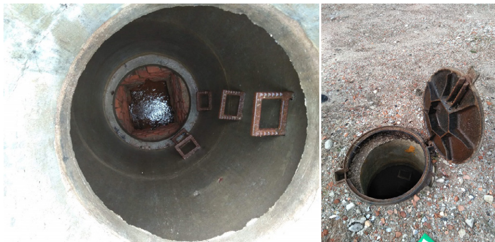
Rys. 4. Studzienka na stanowisku pomiarowym na rzece Lamus (fot. R. Augustyniak)
